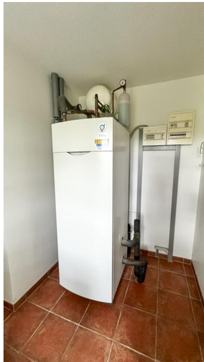
Technik im Hauswirtschaftsraum, EG, Neubau 2006
